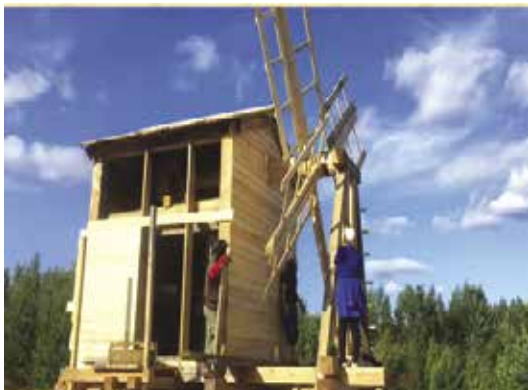
Ил. 4. Центровка вала в ходе проверки работы механизма мельницы
