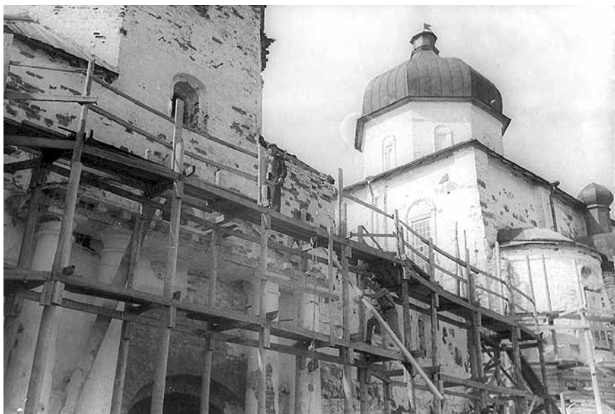
Ил. 4. Апсиды Крестовоздвиженского собора и восточный фасад колокольни Крестного Онежского монастыря. Кий-остров. 1969–1970 гг.
